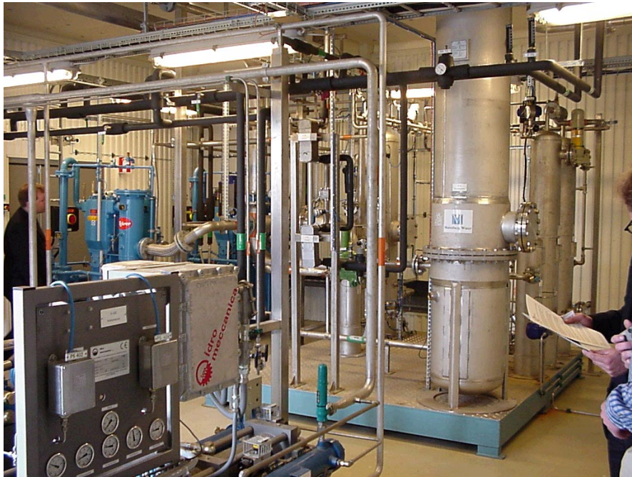
Figur 2. Utrustning för tryckvattenabsorption av biogas.
